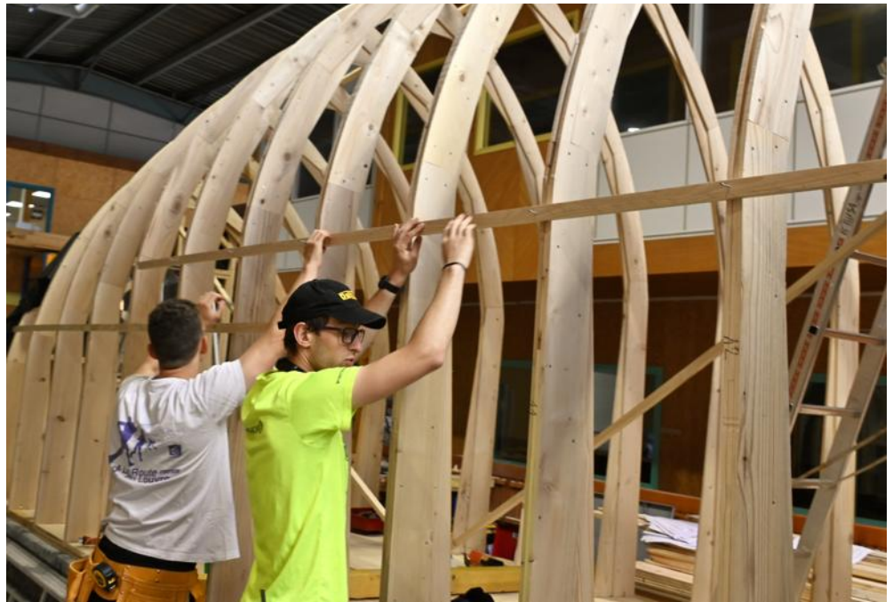
Les structures créées dans le cadre des Défis du bois commencent à se dresser dans les ateliers de l'Enstib ainsi qu'à l'extérieur. Photo Philippe Briqueler
